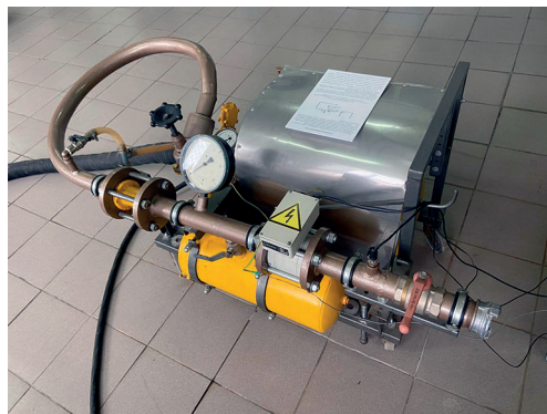
Fig. 2. Pumping unit (photo Oleh Zemlianskyi).
